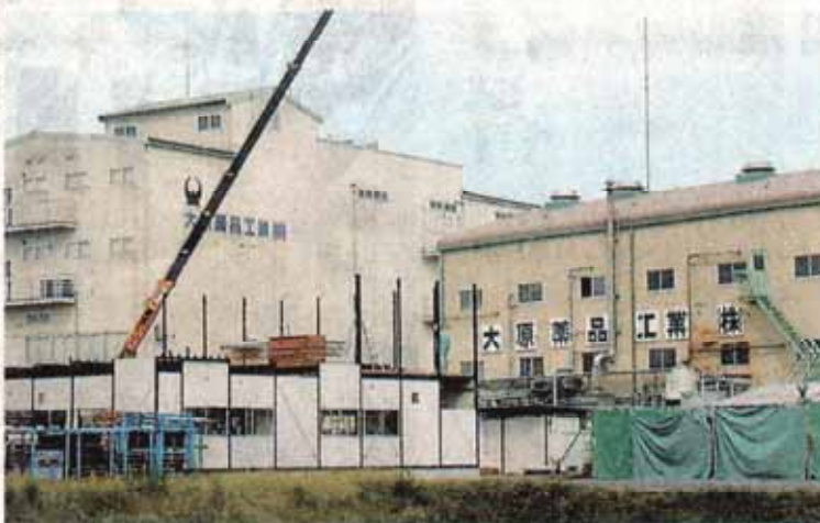
設備の増強を進めるジェネリック医薬品メーカー大原薬品工業の神工場(甲賀市甲賀町神)
